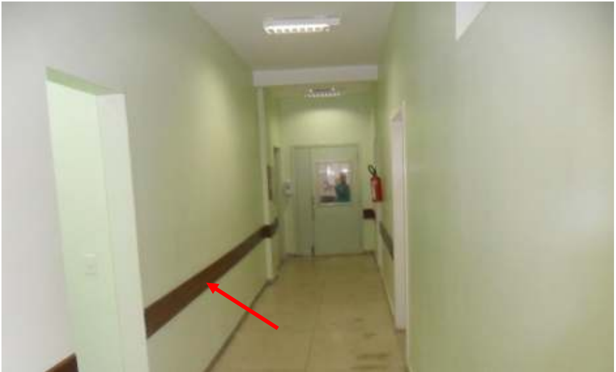
Foto 01 – Bate-macas do Hospital Regional de Araguaína, simplicidade na execução, irrelevância técnica
